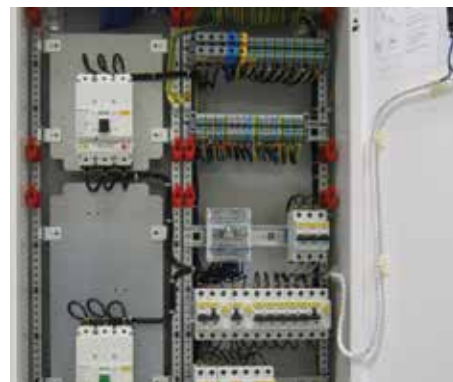
Системы распределения Коммутация силовых распределительных систем
